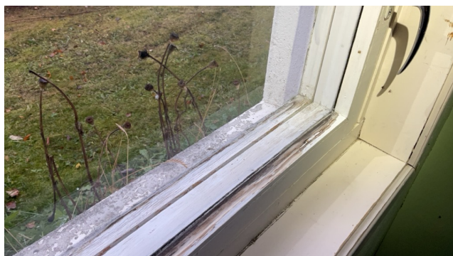
Vinduer fra byggeår må skiftes
