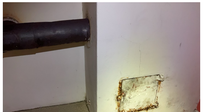
Avstand mellom røykrør til sotluke er for kort
