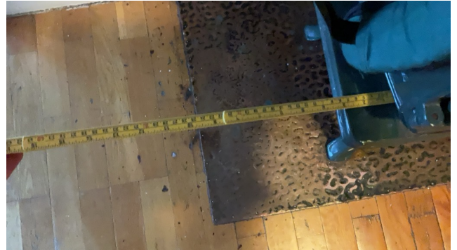
Plate på gulv under ovn er for liten ihenhold til krav
