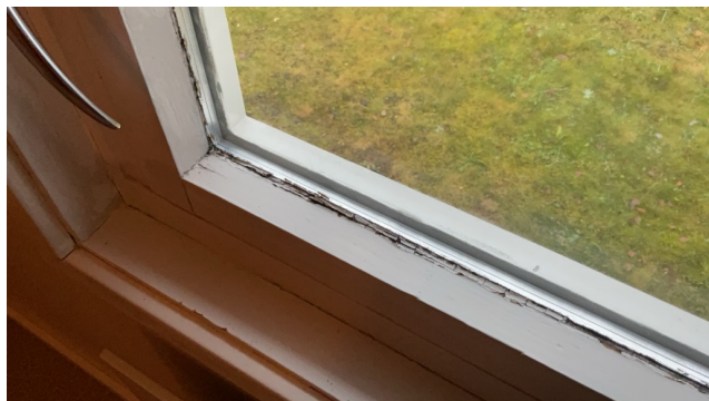
Må påregnes utskifting av vinduer fra byggeår
