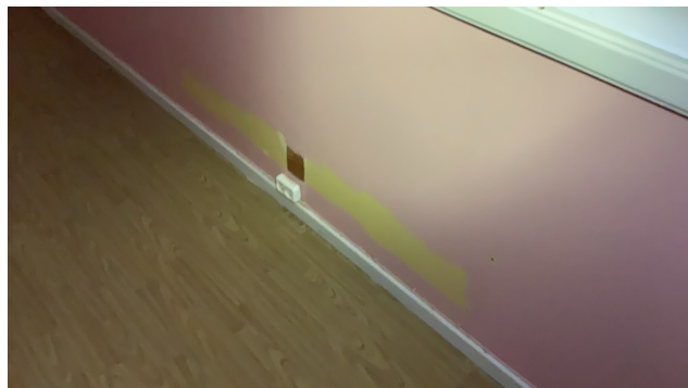
Slitasje med oppussingsbehov av etasjen
