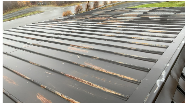
Slitasje og rust på tekking
