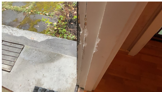
Slitasje i karm der utskifting bør foretas
