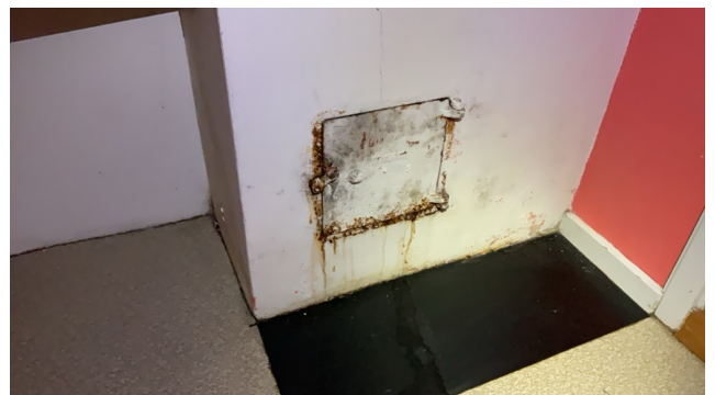
Rennmerke og rust fra sotluke
