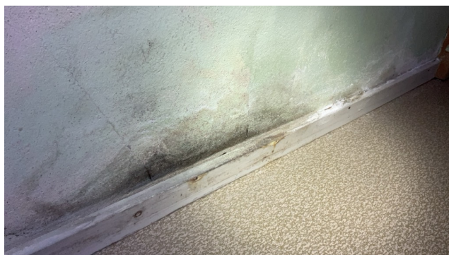
Synlig fuktskjolder med saltutslag og begynnende muggsopp
