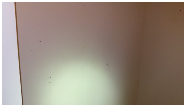
Spikerhull og slitasje på overflater
