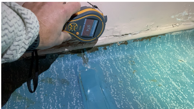
Ved overflatesøk med fuktmåler på yttermur var det fuktutslag
