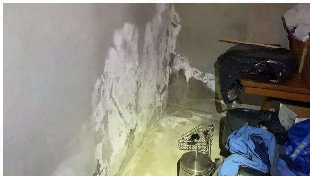
Salt/fuktskjolder i kjeller
