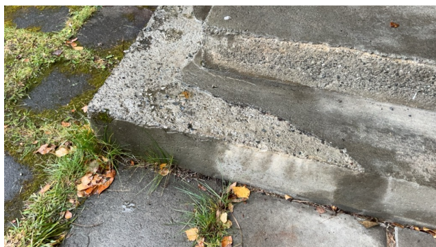
Avskalling av betong
