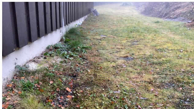
Flatt og manglende terrengfall inntil mur
