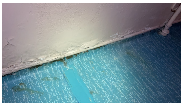
Saltutslag og fukt langs yttermur
