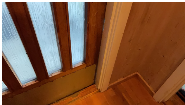
Utettheter i dørblad/karm, luftlekkasjer i overgang
