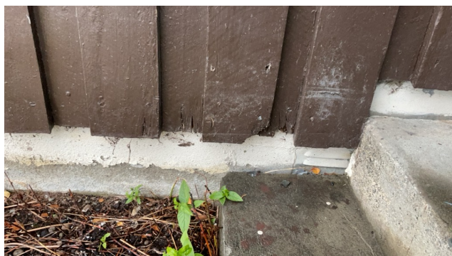
Spredt råteskader i bordkledning
