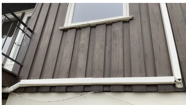
Vedlikeholdsbehov av yttervegger
