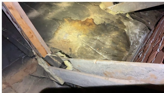
Fuktskjolder på isolasjon mot himling
