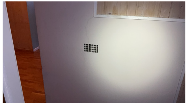
Sprekk i pipe/brannmur
