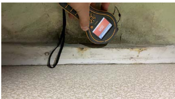
Ved fuktmåletaking med overflatesøk av yttermurer mot terreng var det fuktutslag
