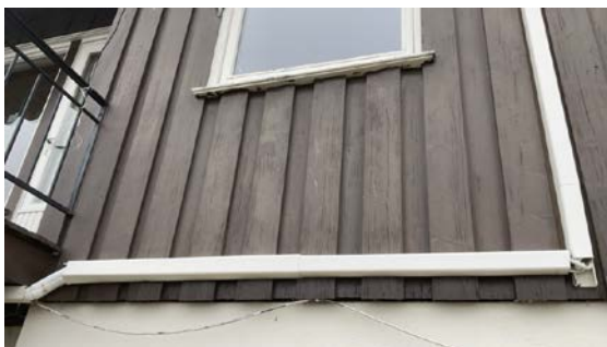
Vedlikeholdsbehov av yttervegger
