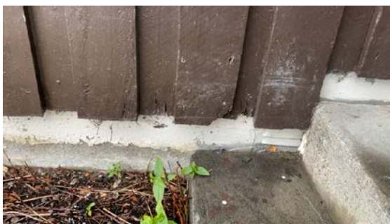
Spredt råteskader i bordkledning
