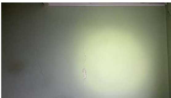
Fra kjeller er det registrert sprekker i mur
