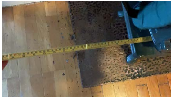
Plate på gulv under ovn er for liten ihenhold til krav
