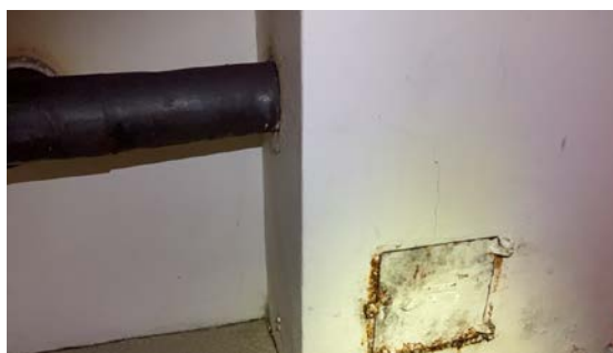
Avstand mellom røykrør til sotluke er for kort
