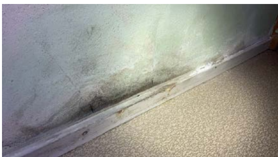
Synlig fuktskjolder med saltutslag og begynnende muggsopp
