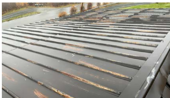
Slitasje og rust på tekking
