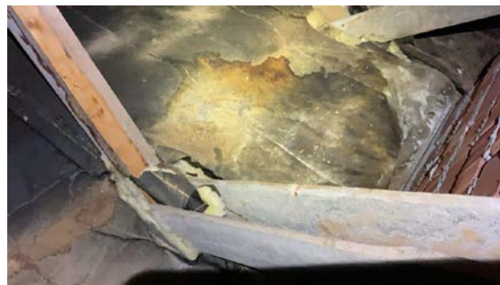
Fuktskjolder på isolasjon mot himling
