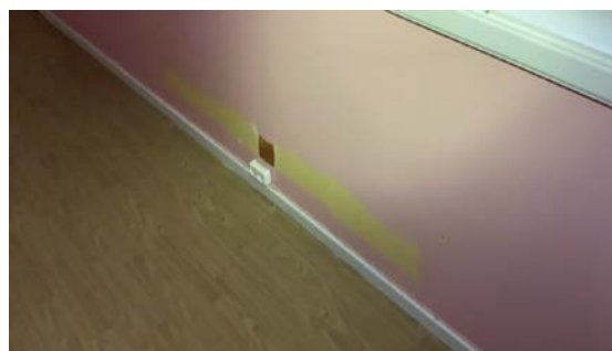
Slitasje med oppussingsbehov av etasjen
