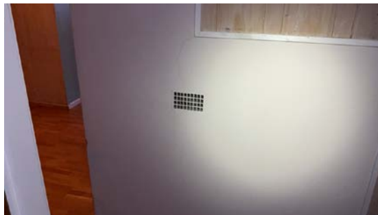
Sprekk i pipe/brannmur
