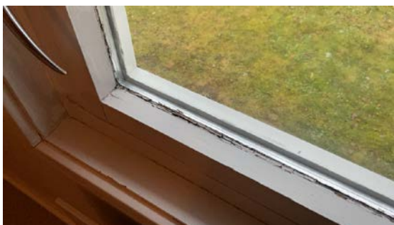
Må påregnes utskifting av vinduer fra byggeår
