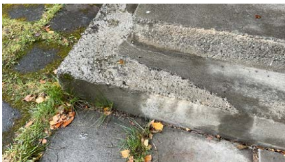
Avskalling av betong
