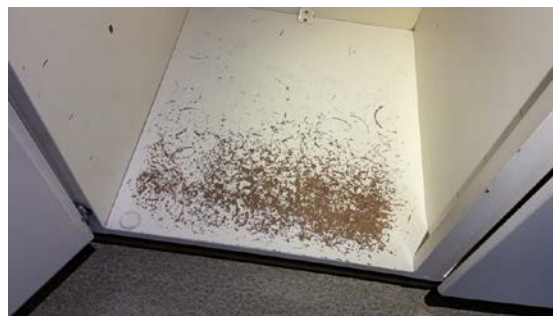
Slitasje i skap
