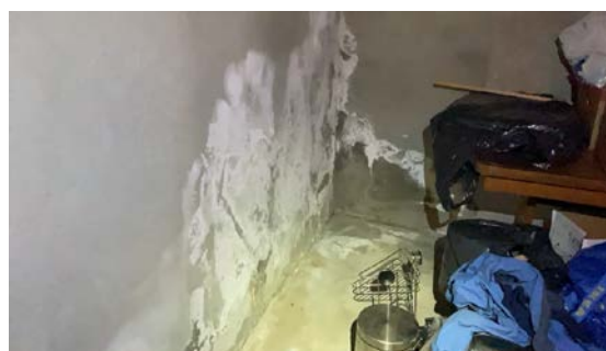
Salt/fuktskjolder i kjeller
