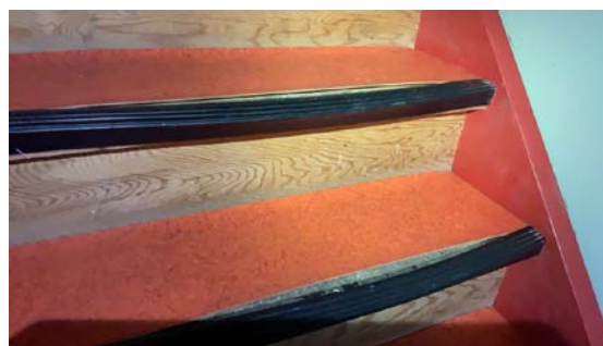
Trapp er slitt der belegg har løsnet
