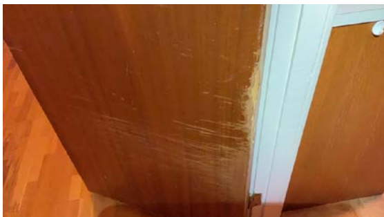
Skader på dører
