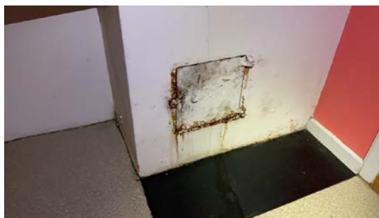
Rennermerke og rust fra sotluke
