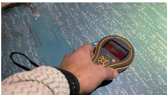
Ved overflatesøk med fuktmåler på gulv mot grunn var det fuktutslag
