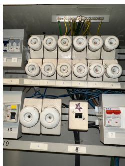
Sikringsskap med automatsikringer.
