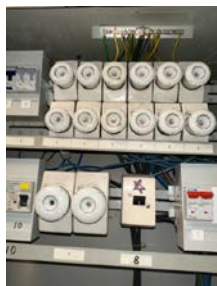
Sikringsskap med automatsikringer.
