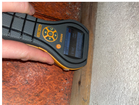
Det måles forhøyede fuktverdier i treverk
