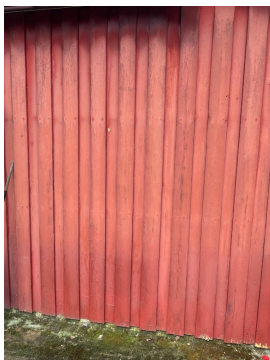
Værslitt og oppsprukket kledning
