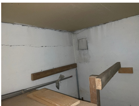
Synlige sprekker i m
