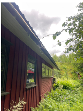
Utvendig på- fyllingsrør for nedgravd oljetank
