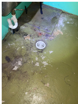
Skader i overflatebehandling og rundt sluk.
