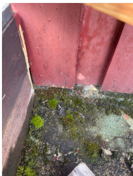
Påbegynnende råteskader i nedkant av kledning
