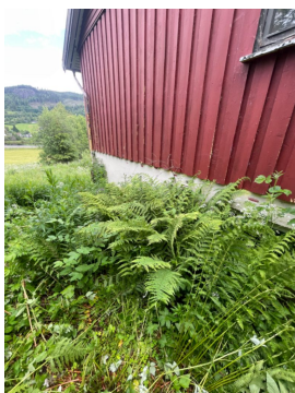
Værslitt og oppsprukket kledning
