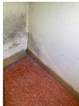
Synlig saltutslag og svertesopp
