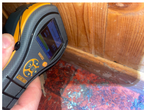
Det måles forhøyede fuktverdier i treverk
