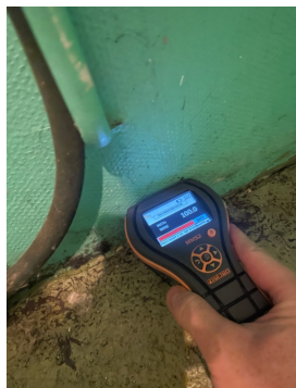
Forhøyede fuktverdier i delevegg mot wc
