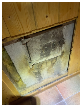
Brennbart materiale nære sotluke
