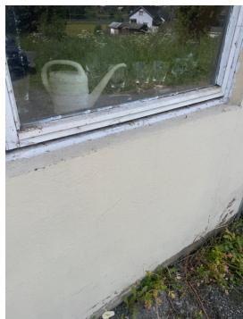
Værslitte og oppsprukket treverk.
