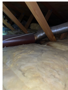
Synlig luftlekkasje rundt ventilasjonsrør. Matos havner i isolasjon.
