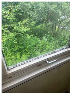
Synlig kondensering innvendig.
