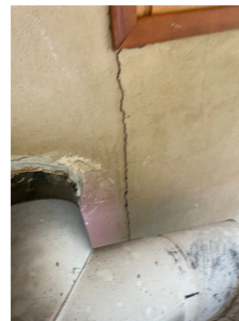
Sprekk i mur og avvik rundt røykrør
