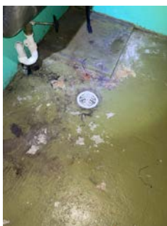
Skader i overflatebehandling og rundt sluk.
