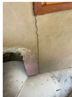
Sprekk i mur og avvik rundt røykrør
