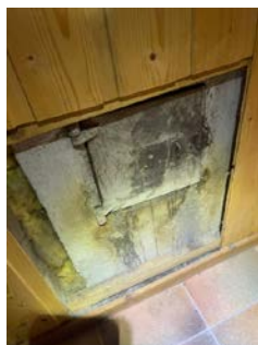
Brennbart materiale nære sotleuke
