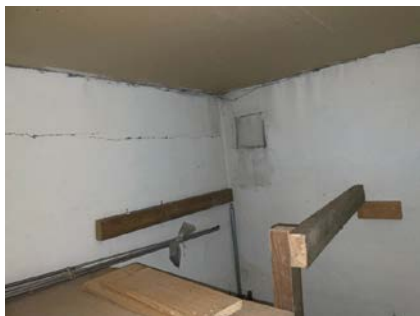
Synlige sprekker i m
