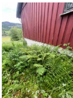
Værslitt og oppsprukket kledning
