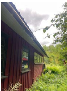
Utvendig på- fyllingsrør for nedgravd oljetank
