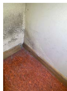
Synlig saltutslag og svertesopp
