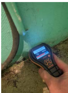
Forhøyede fuktverdier i delevegg mot wc
