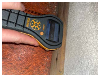
Det måles forhøyede fuktverdier i treverk
