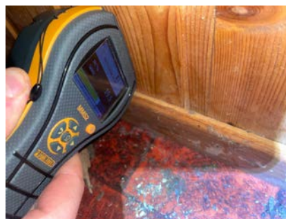
Det måles forhøyede fuktverdier i treverk
