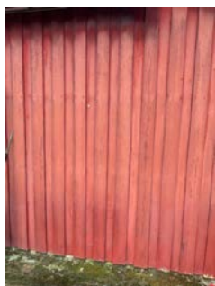
Værslitt og oppsprukket kledning
