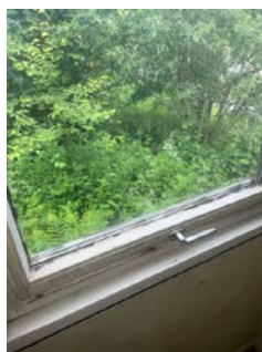
Synlig kondensering innvendig.
