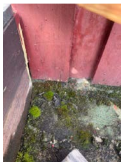
Påbegynnende råteskader i nedkant av kledning
