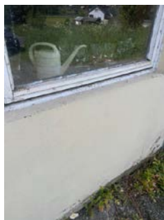
Værslitte og oppsprukket treverk.
