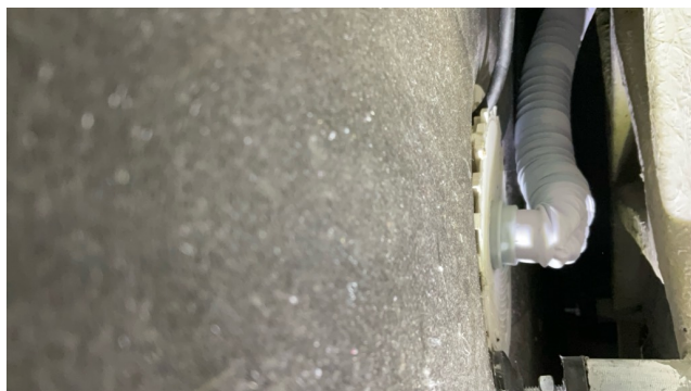
Plastsluk i gulv under dusjkabinett
