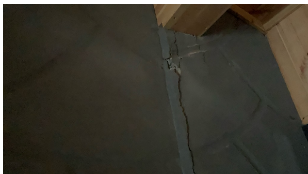
Sprekkdannelser mellom pipe og peis/ brannmur
