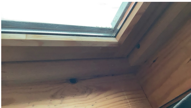
Eldre kobla vindu med misfarging
