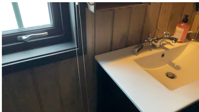
Manglende membran / fuktsikring våtzone ved vask
