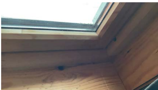
Eldre kobla vindu med misfarging
