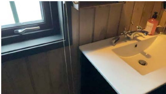
Manglende membran / fuktsikring våtzone ved vask
