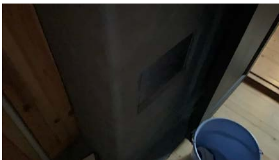
Feieluke uten ildfast plate på gulv
