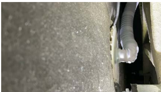
Plastsluk i gulv under dusjkabinett
