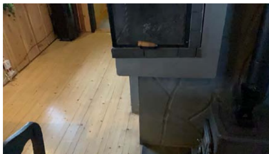
Åpen pais uten plate på gulv rundt åpning.
