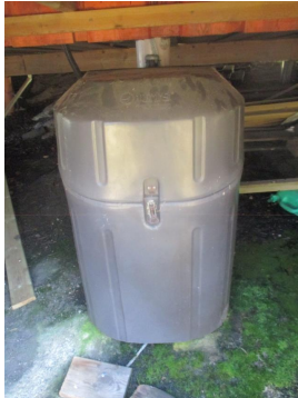
Underliggende tank som må tømmes ved jevne mellomrom.
