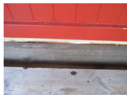
Utvendige svillbeslag på ytterdører mangler.
