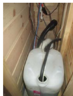
Vannbeholder og vakumpumpe.
