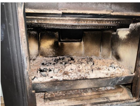
Sprekker i ildfast stein i peisovn stue.
