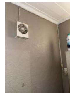
Ufagmessig tilkobling av vifte.
