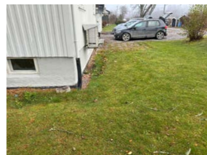
Terreng med feil fall inn mot bygningskropp
