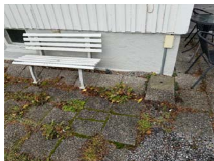
Terreng går over fuktsikring av grunnmur.
