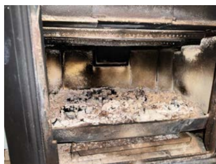
Sprekker i ildfast stein i peisovn stue.
