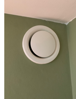
Felles forsert avtrekk like ved kokesone
