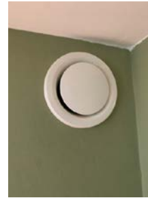
Felles forsert avtrekk like ved kokesone
