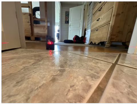
Ingen terskel/tettesjikt ved døråpning.
