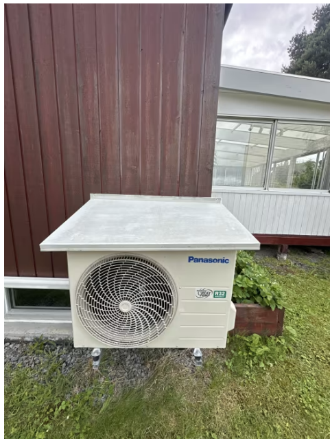
Viser utedel luft - luft varmepumpe.
