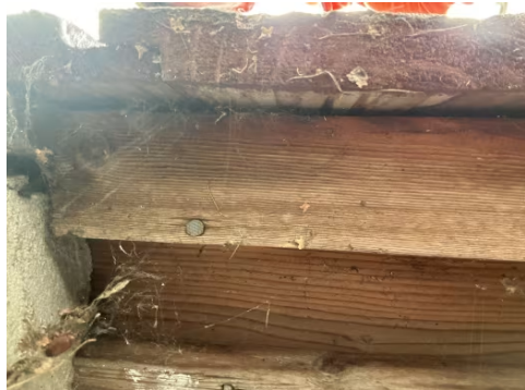
Kledningen er ikke luftet.
