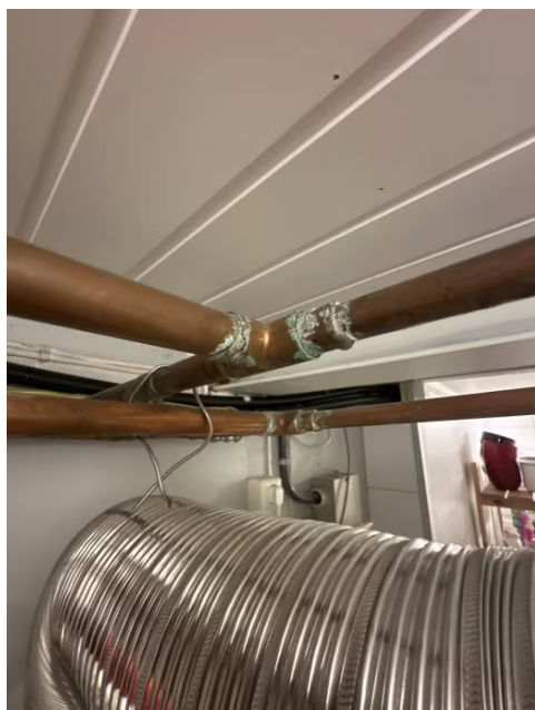
Det registreres irr på koblinger.
