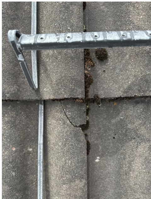
Det registreres knekte takstein og mosegroing.
