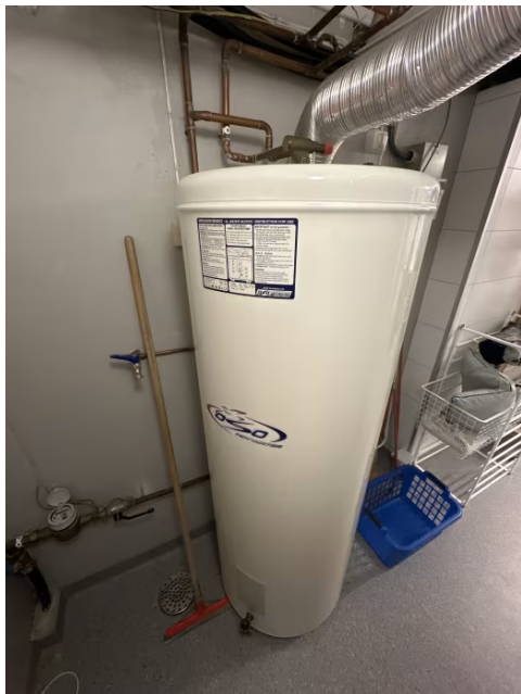
Viser varmtvannsbereder plassert på vaskerom.
