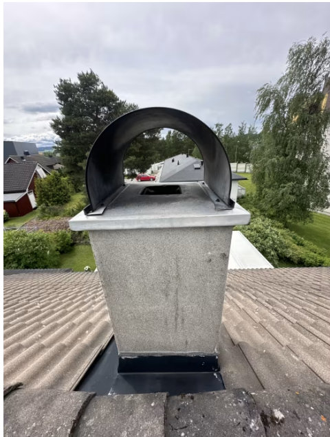
Viser pipe over tak.
