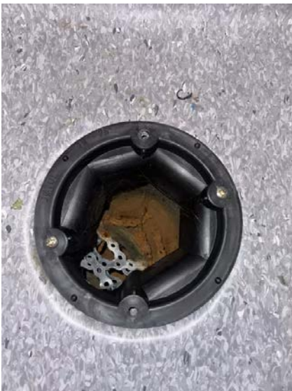
Sluk er løs, klemring mangler skruer og det registreres utettheter. Anbefaler ytterligere undersøkelser av sluk.
