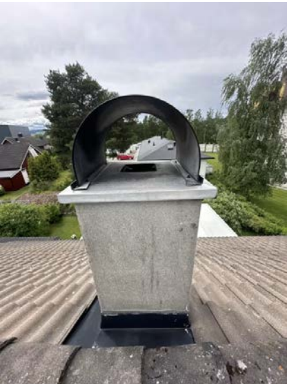
Viser pipe over tak.
