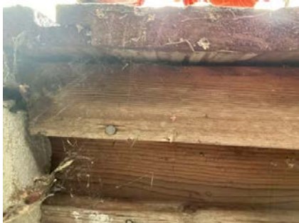
Kledningen er ikke luftet.
