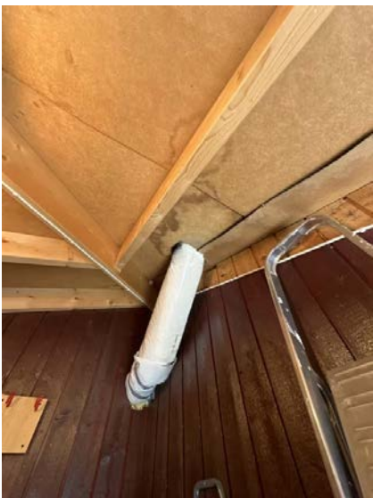
Det registreres fukstkjelder på sutaksplater. Antatt gjennomføring fra avtrekk på kjøkken. Anbefaler ytterligere undersøkelser.
