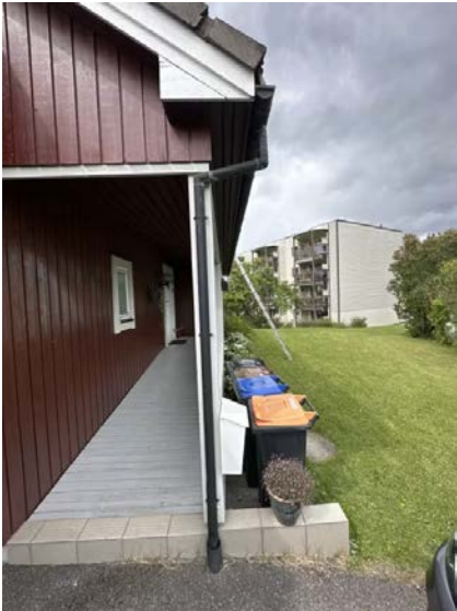
Nedløpsrør er ført til lukket avløp i grunnen. Avløpssystem i grunnen er ikke kontrollert.
