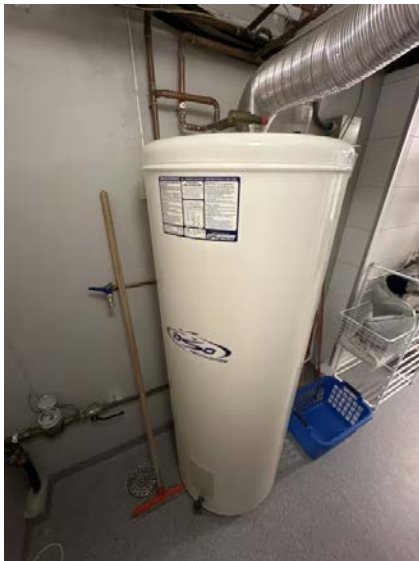
Viser varmtvannsbereider plassert på vaskerom.
