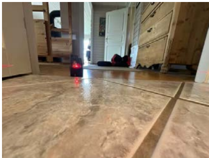
Ingen terskel/tettesjikt ved døråpning.
