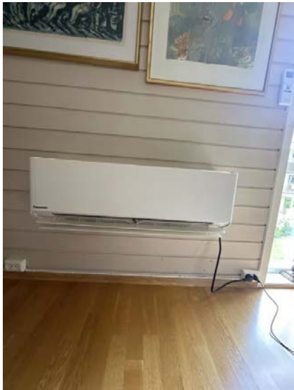
Viser innedel montert i stue.
