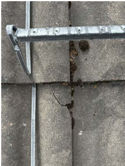
Det registreres knekte takstein og mosegroing.
