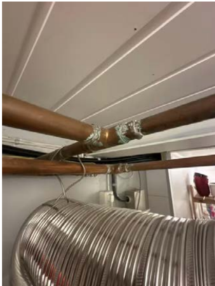
Det registreres irr på koblinger.
