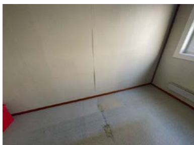
Eksempel på skader for overflater.
