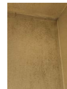
Svertesopp på vegg og himling.
