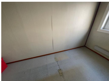
Eksempel på skader for overflater.
