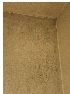
Svertesopp på vegg og himling.
