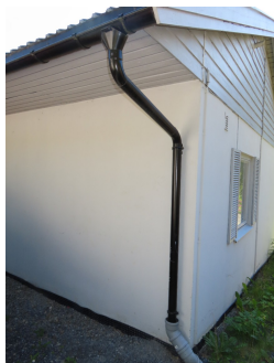
Nedløpsrør ført til nedgravde rør som er ført vekk fra vegglivet.
