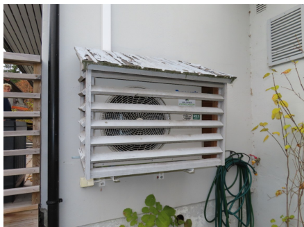
Ny varmepumpe i 2025 - installert av dagens eier.
