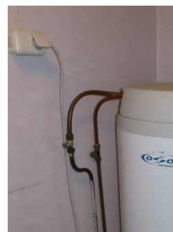
Berederen er tilknyttet det elektriske anlegget via enklere stikkontakt - det anbefales fast tilknytning med bryter.
