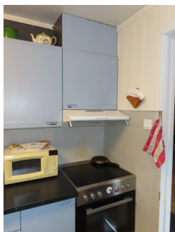
Ventilator med avtrekkslange ført opp gjennom himling - ukjent hvor det er ført videre - det anbefales ytterligere undersøkelse.
