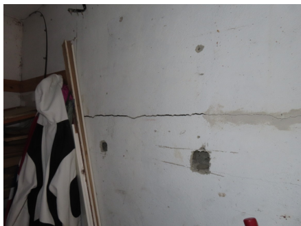
Påvist sprekk i fuger inne i garasjeboden.
