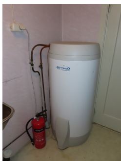
200 liters varmtvannsbereder fra 2017.
