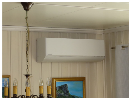
Innvendig viftekonvektor på luft til luft varmepumpe.
