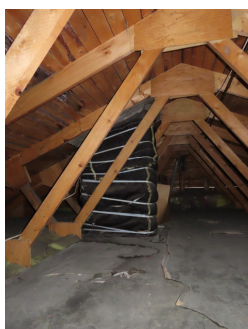
Pipen oppe på loftet ses isolert for å unngå nedkjøling og kondensering. Dette ble gjort for mange år siden, før det ble satt inn foringsrør.
