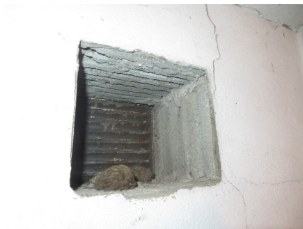
Påvist sprekk/rissprekk i murvegg inne i garasjeboden.
