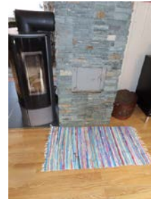
Sotluke i stue, hvor det ses å mangle ubrennbar plate/sikring til gulv.
