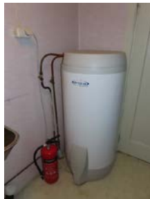
200 liters varmtvannsbereder fra 2017.
