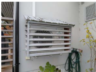
Ny varmepumpe i 2025 - installert av dagens eier.
