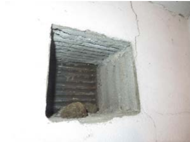
Påvist sprekk/rissprekk i murvegg inne i garasjeboden.
