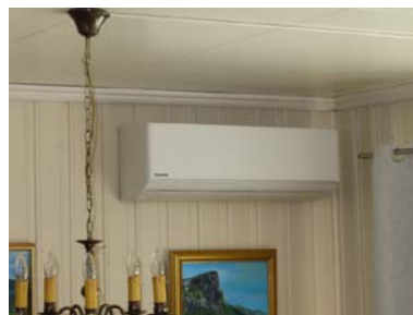
Innvendig viftekonvektor på luft til luft varmepumpe.
