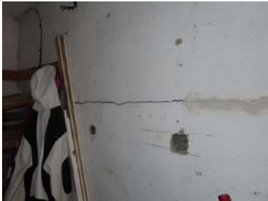
Påvist sprekk i fuger inne i garasjeboden.
