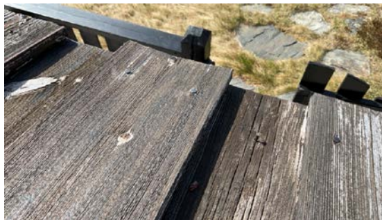
Registrert spikeropptrekk på innfesting
