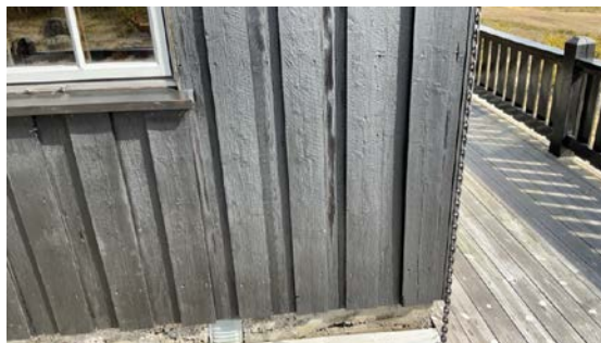
Sprekkdannelse i kledning
