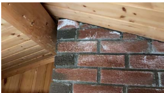
Saltutslag rundt pipestamme
