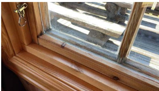
Slitasje i karm
