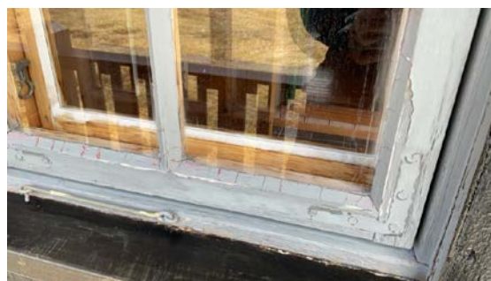
Slitasje på vinduer med sprekkdannelser i kitt
