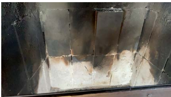
Ildfast stein i peisgrue er løse og manglende fuger
