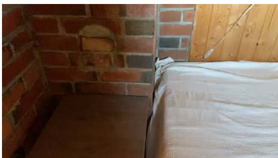
Seng er plassert inntil pipe
