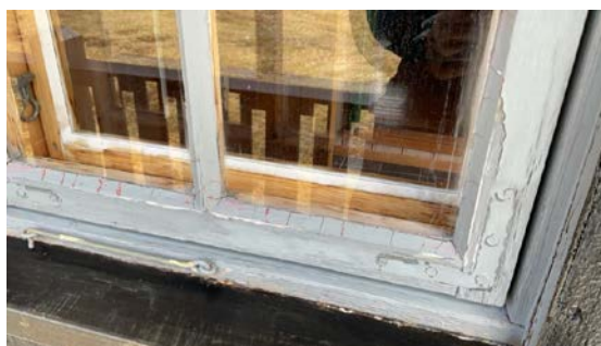
Slitasje på vinduer med sprekkdannelser i kitt
