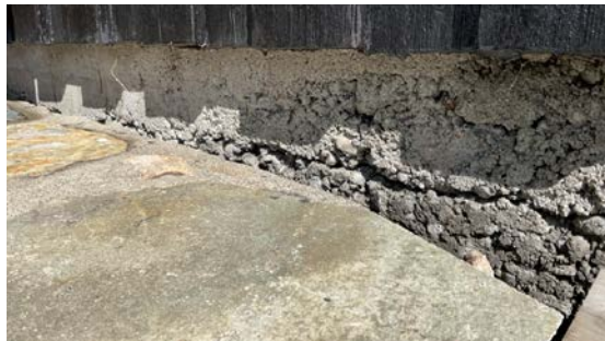
Sprekk i mur
