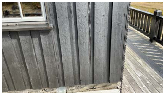
Sprekkdannelse i kledning
