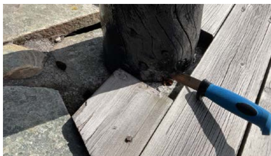
Råte i stolpe til overbygd inngangsparti og bæring for takkonstruksjon og må foretas tiltak
