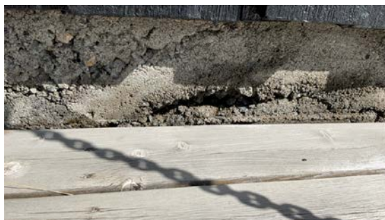
Forvitring av mur
