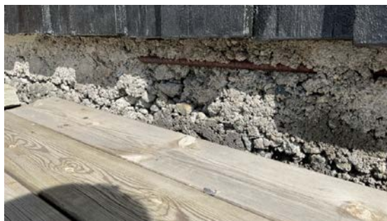
Synlig armering, bemerket rust
