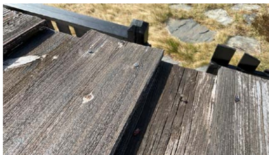
Registrert spikeropptrekk på innfesting
