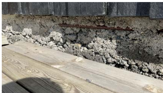
Synlig armering, bemerket rust
