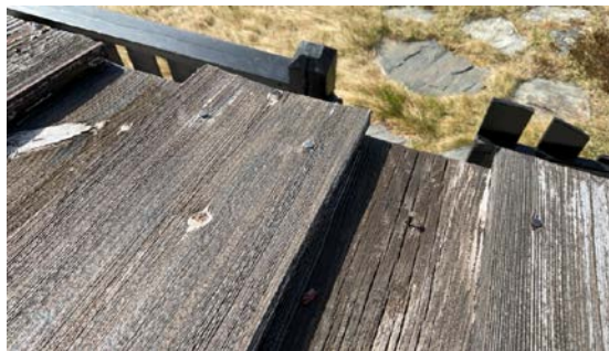
Registrert spikeropptrekk på innfesting
