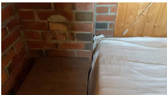
Seng er plassert inntil pipe
