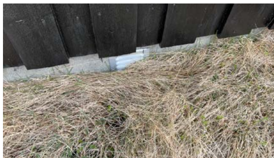
Begrenset lufting og er tilgrodd stedvis, bør etableres bedre lufting med fjerning av torv
