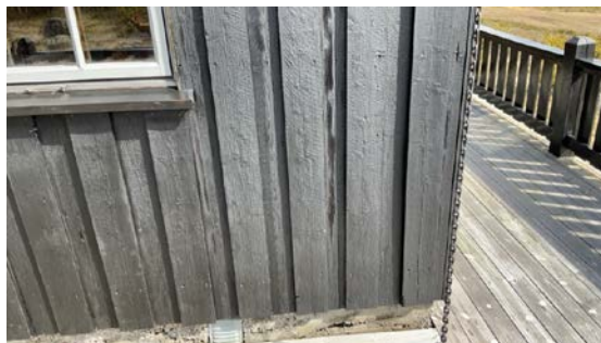
Sprekddannelser i kledning
