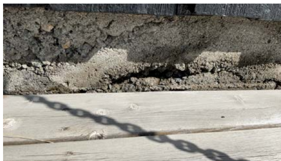
Forvitring av mur
