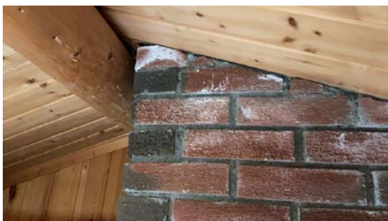
Saltutslag rundt pipestamme
