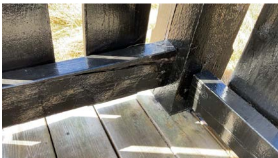
Skade i rekkverk
