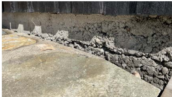
Sprekk i mur
