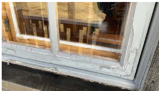
Slitasje på vinduer med sprekkeformasjoner i kitt
