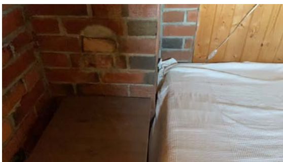
Seng er plassert inntil pipe
