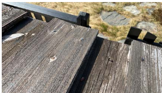
Registrert spikeropptrekk på innfesting
