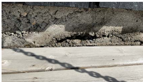
Forvitring av mur
