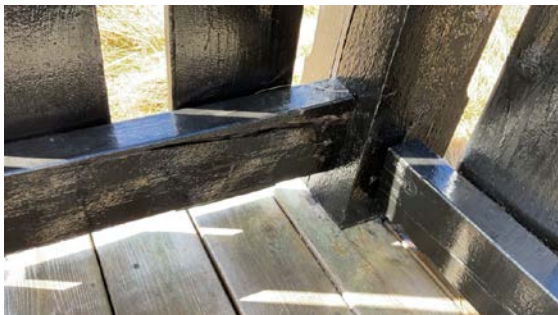
Skade i rekkverk
