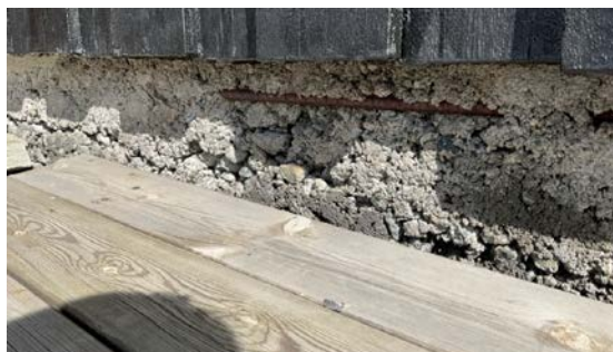
Synlig armering, bemerket rust
