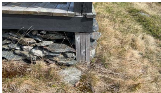
Skjevheter i terrasse, årsaksammenheng med bærekonstruksjon/fundament og grunnforhold. Skjevhet i pilar av tre.
