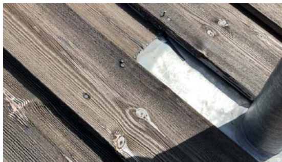
Overgang lufting er ikke synlig, bør etableres med beslag til over møne i overgang yttertak
