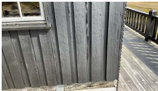
Sprekddannelser i kledning
