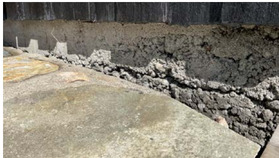
Sprekk i mur
