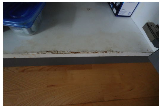
Viser skade i bunn av kabinett under kjøkkenkum.
