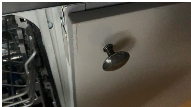
Viser svelleskade på front ved siden av oppvaskmaskin
