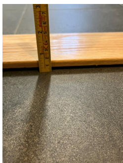
Åpningspalte under dørterskel til vaskerom
