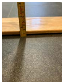
Åpningspalte under dørterskel til vaskerom
