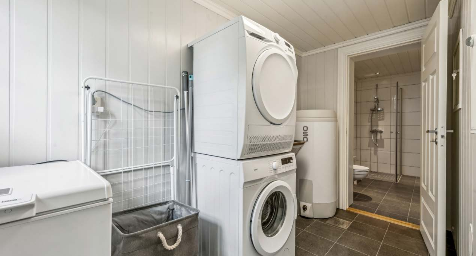
I tillegg til skyllekar og god plass for vaskemaskin og tørketrommel, huser også vaskerommet hyttas tekniske utstyr
