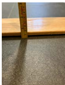
Åpningspalte under dørterskel til vaskerom
