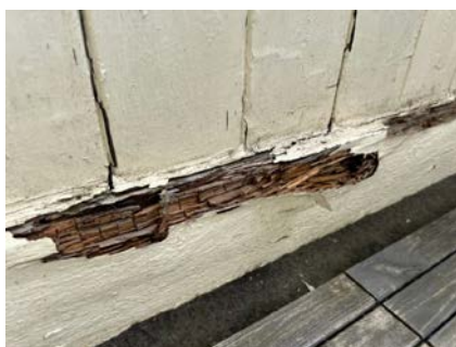
Råte i rekkverkskonstruksjon på terrasse mot vestlig retning
