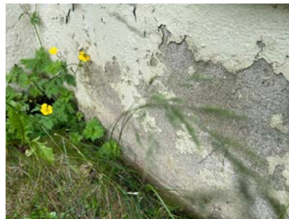
Avflassing på mur registrert på overside, ikke registrert drenering mot mur
