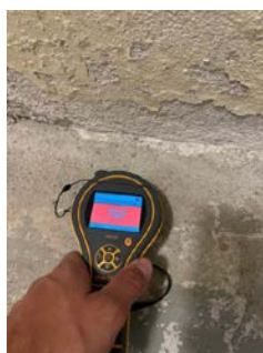
Ved overflatesøk med fuktmåler mot gulv på grunn var det utslag
