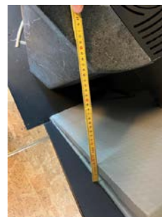
For kort avstand mellom ovn og brennbart materiale på kjøkken
