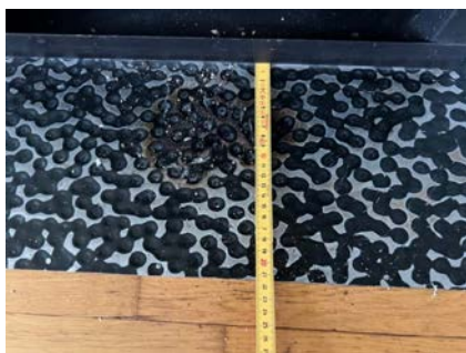
Plate på gulv under/foran ovn i stue er for kort ihenhold til krav
