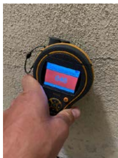
Ved overflatesøk med fuktmåler mot yttermur var det utslag
