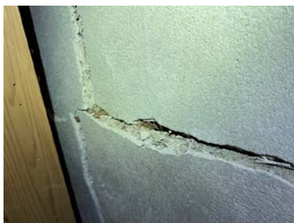
Sprekker/utgliding av mur mot østlig retning, jmf eier foretatt lokale tiltak utvendig
