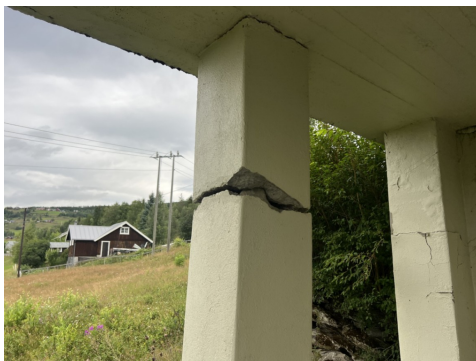
Fundament til terrasse mot vest har knekt med utsig
