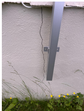
Sprekker i mur, anbefales ettersyn og tiltaksbehov vurderes
