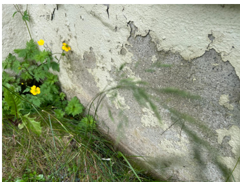
Avflassing på mur, ikke registrert drenering mot mur
