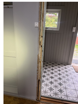
Gjenstående arbeid og slitasje
