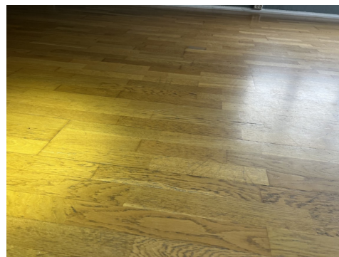
Slitasje på gulvoverflate
