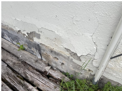
Forvitring av mur/puss med sprekk
