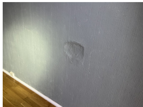
Avvik på overflate
