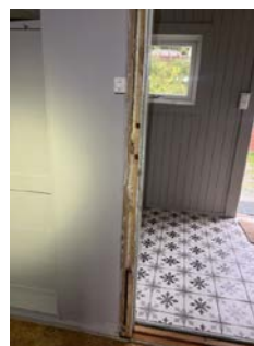
Gjenstående arbeid og slittasje
