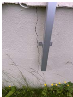
Sprekker i mur, anbefales ettersyn og tiltaksbehov vurderes
