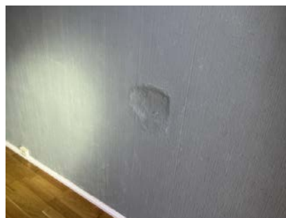
Avvik på overflate
