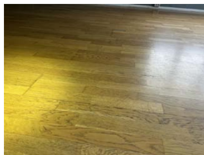
Slitasje på gulvoverflate
