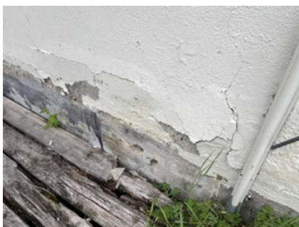
Forvitring av mur/puss med sprekk
