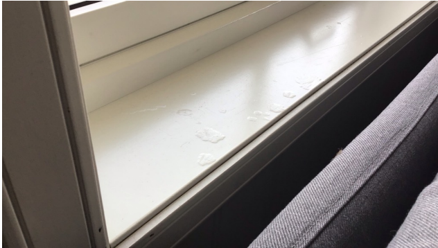
Bildet viser svelleskader på vindusforing.
