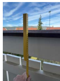
Bildet viser høyden på rekkverker på verandaen.
