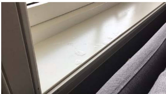
Bildet viser svelleskader på vindusforing.
