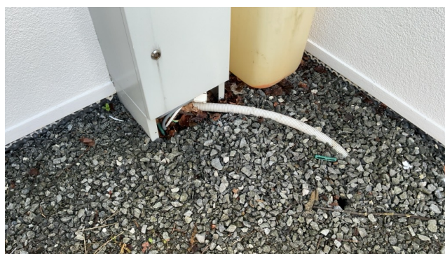
Synlige kabler/trekkerør v/ utvendig EL-skap
