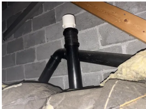
Vakuu/ durgoventil på kaldloftet
