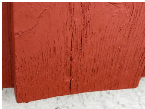
Stedvis værslitt kledning.
