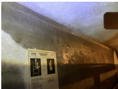
Synlig fukt/ kondens på fritt eksponerte murflater i tilfluktsrommet.
