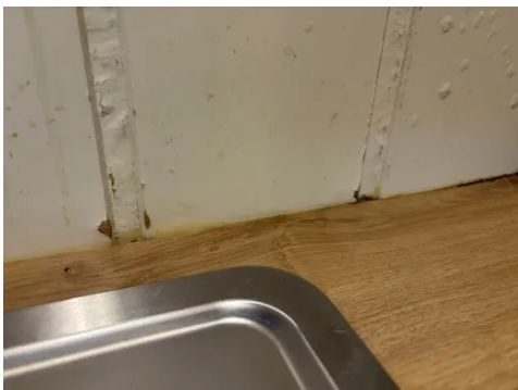
Synlige fuktmerker på panelplater ved vask.
