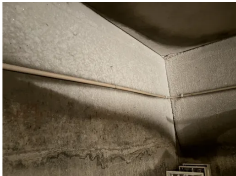
Synlig rim/ kondens på fritt eksponerte murflater i tilfluktsrommet.
