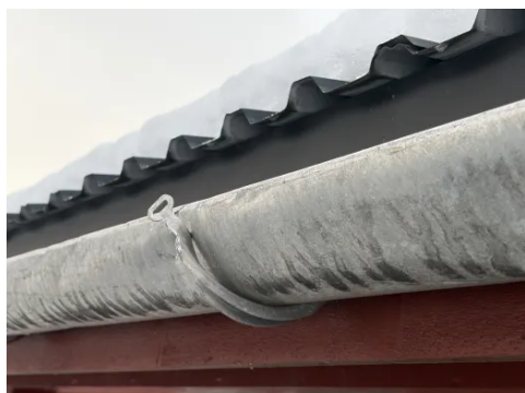
Synlige skader på takrenner/ kroker.
