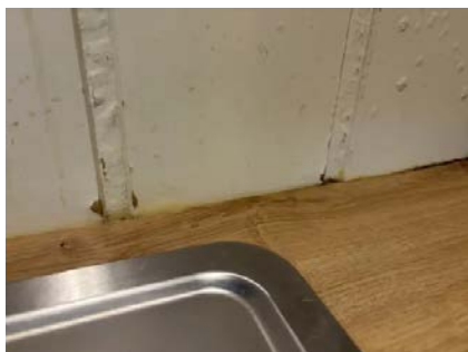
Synlige fuktmerker på panelplater ved vask.
