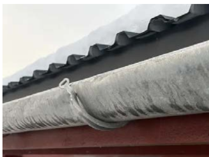
Synlige skader på takrenner/ kroker.
