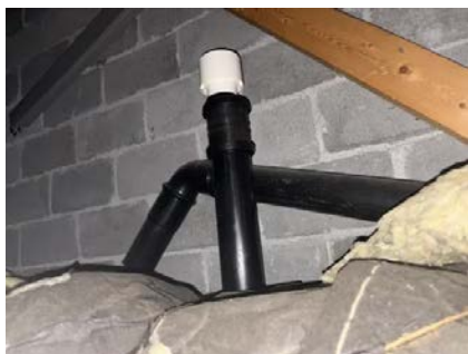
Vakuumburgventil på kaldloftet
