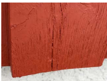
Stedvis værslitt kledning.
