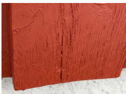
Stedvis værslitt kledning.
