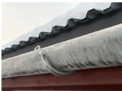
Synlige skader på takrenner/ kroker.
