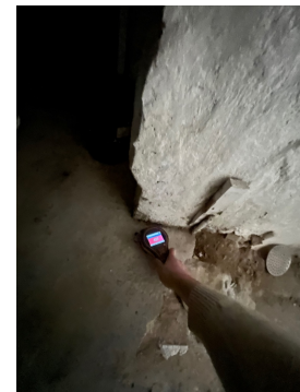
«Rødt» utslag på overflatefuktsøk
