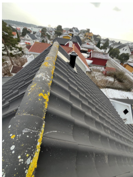
Noe mose, spesielt på vestsiden av taket
