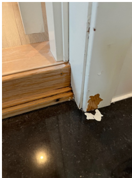
Avflassing av maling og noe tegn til fuktskadede ved dør
