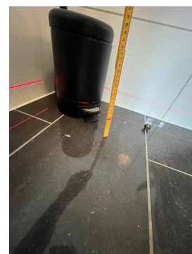
Motfall mot hjørnet ved vannfordelerskap
