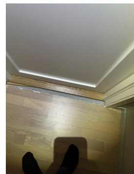
Feielist inntil dørterskel ved soverom i kjelleretasje mot Nord mangler
