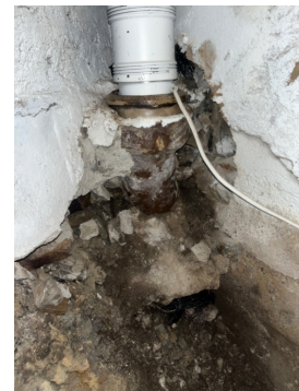
Overgang mellom støpejern og plast.
