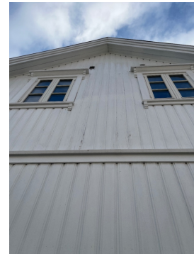
Vegg mot nord trenger vedlikehold
