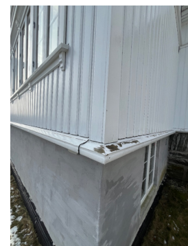
Avflasket maling på vannbrett.
