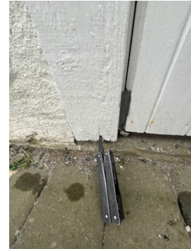
Påbegynnende råteskade nederst i belistning.
