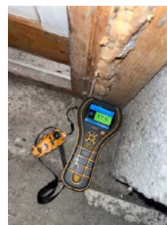
Noe forhøyet fukt-% målt i bunn fra innersiden der belistning er skadet.
