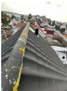
Noe mose, spesielt på vestsiden av taket
