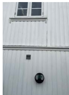
Vegg mot sør trenger vedlikehold
