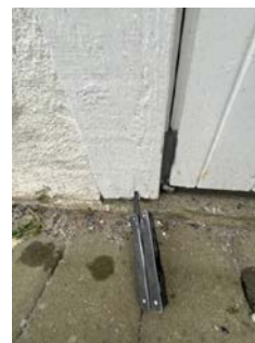
Påbegynnende råteskade nederst i belistning.
