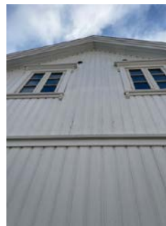
Vegg mot nord trenger vedlikehold
