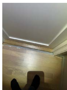
Feielist inntil dørterskel ved soverom i kjelleretasje mot Nord mangler
