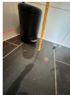
Motfall mot hjørnet ved vannfordelerskap
