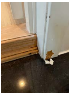
Avflassing av maling og noe tegn til fuktskadet ved dør
