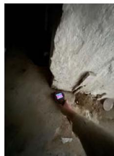
«Rødt» utslag på overflatefuktsøk
