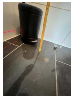
Motfall mot hjørnet ved vannfordelerskap
