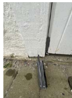
Påbegynnende råteskade nederst i belistning.
