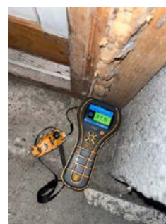
Noe forhøyet fukt-% målt i bunn fra innersiden der belistning er skadet.
