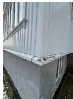
Avflasset maling på vannbrett.
