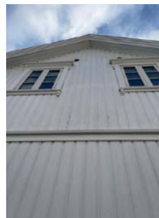
Vegg mot nord trenger vedlikehold
