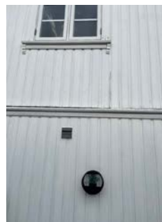
Vegg mot sør trenger vedlikehold
