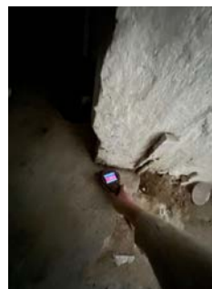
«Rødt» utslag på overflatefuktsøk
