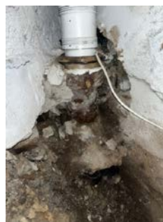
Overgang mellom støpejern og plast.
