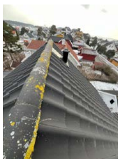
Noe mose, spesielt på vestsiden av taket
