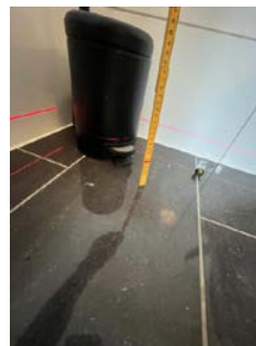
Motfall mot hjørnet ved vannfordelerskap
