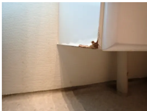
Fuktskader på nedre del av baderomsinnredning.
