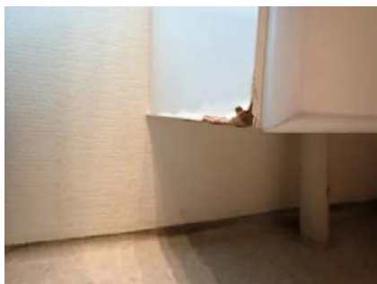
Fuktskader på nedre del av baderomsinnredning.
