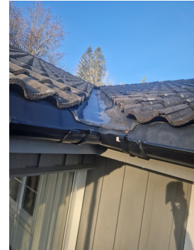
Synlig avskaling plastbelegg gradrenner.
