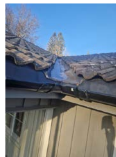
Synlig avskaling plastbelegg gradrenner.
