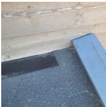
Mangler lufting ved bodtilbygg
