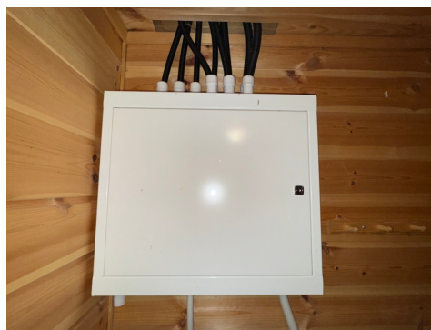
Fordelerskap for rør plassert i innvendig bod
