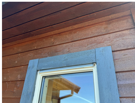
Vindu mangler vannbord
