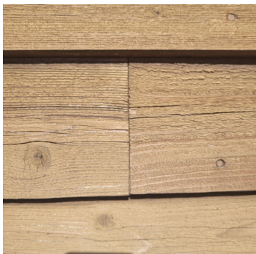
Oppsprekninger i treverket
