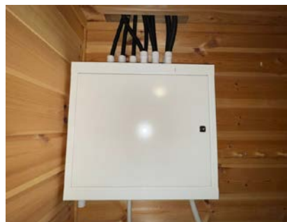
Fordelerskap for rør plassert i innvendig bod
