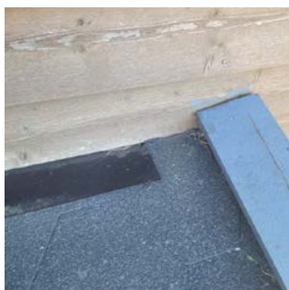
Mangler lufting ved bodtilbygg
