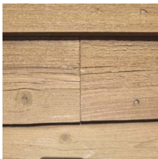
Oppsprekninger i treverket
