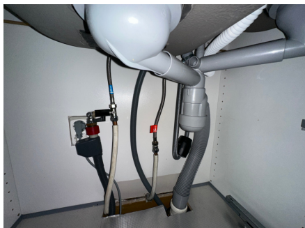
Røropplegg i kjøkkenbenk
