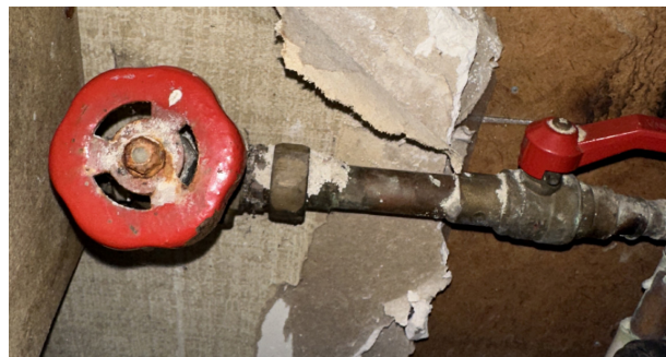
Stoppekraner plassert på bad
