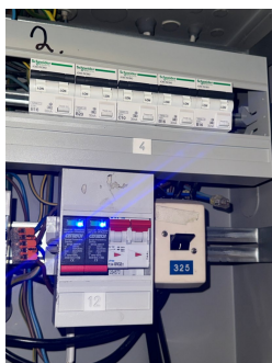
Sikringsskap med automatsikringer.
